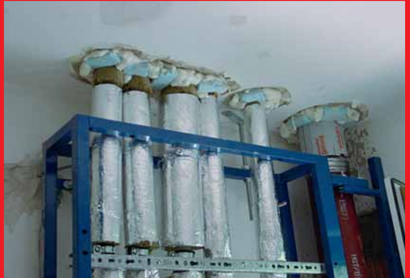
Umständliche Schalung mit Bauschaum. Gefahr durch eine zu geringe Überdeckung der Öffnung mit Mörtel.
