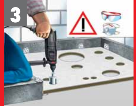
3 Einfaches Herstellen der Öffnungen (Arbeitsschutz und Montageanleitung beachten!) - z. B. mit Lochsäge oder Stichsäge
