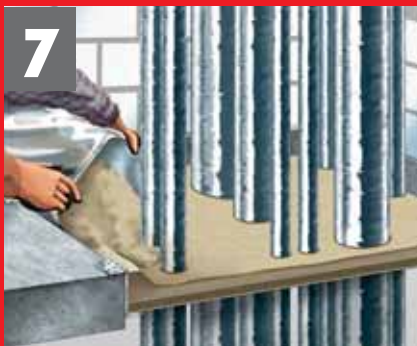
7 Zweites Befüllen Deckenöffnung mit Trockenschüttung befüllen und wiederum gleichmäßig im Schacht verteilen
