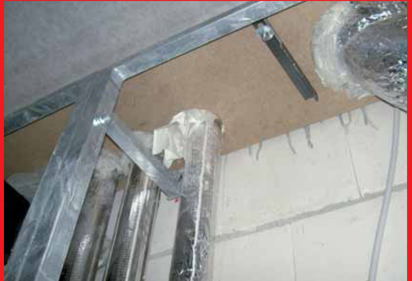
Brennbare Schalungen führen zu einer unerwünschten Erhöhung der Brandlast.
